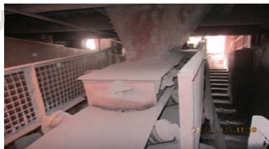
شکل ۴. طراحی و اجرای نامناسب پرده گردوغبار
