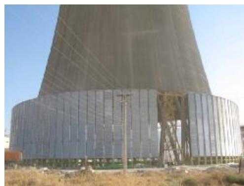
شکل ۴: سازه دریچه متصل به یک برج خنک کن.
