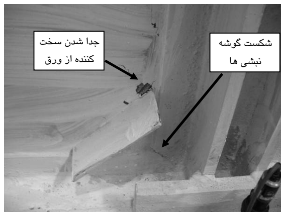
شکل (۷): شکست گوشه های نبشی و جداشدگی سخت کننده شماره ۱۱ از ورق
