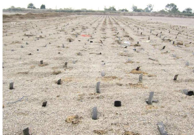
شکل ۶: نمای کلی از نصب و آرایش مثلثی زهکش های قائم در پروژه پیش بارگذاری واحدهای زلزال ساز سربندر خوزستان
