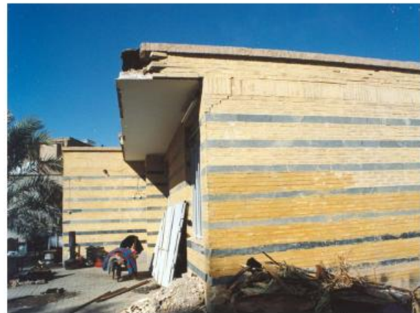
شکل ۲: آسیب دیدگی جزئی یک ساختمان آجری کلافدار (ساختمان منابع طبیعی بم) در زلزله ۲۰۰۳ بم [۱]
