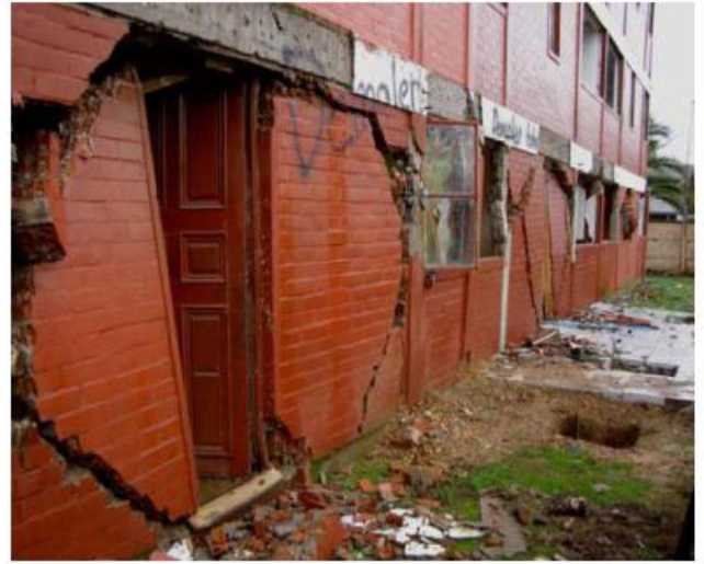
شکل ۳: عملکرد ساختمان‌های آجری کلافدار در زلزله سال ۲۰۱۰ شیلی، ساختمان سه طبقه، آسیب در طبقه اول [۶]
