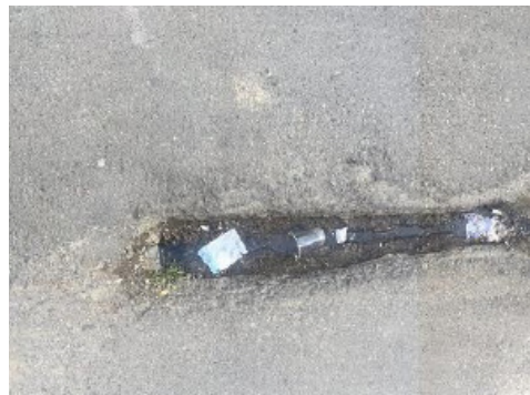
الف) سطح روسازی دارای خرابی چاله
