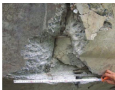
الف) ترک عمیق در شاه تیر اصلی
