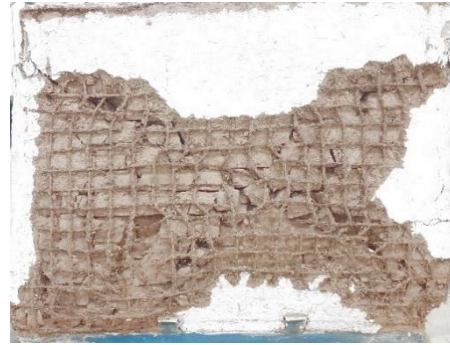
شکل ۹. مود شکست برشی و خردشدگی پاشنه ناشی از حرکت گهواره ای نمونه W5 و گسیختگی تارهای افقی مش
