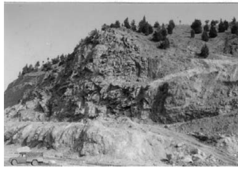
شکل ۴: کیلومتر ۵۰/۰۳ آزاد راه، دید به سمت شمال شرق، در آن خردی و شکستگی سنگها به وضوح مشخص است
