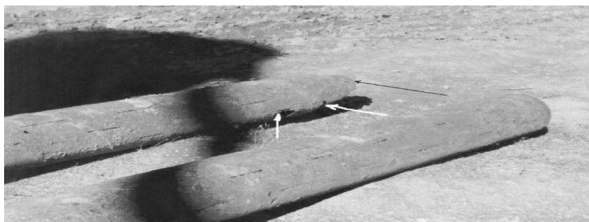
شکل ۲- لوله‌های فلزی خورده و پوسیده شده در چاه‌های گازدار منطقه قهاوند
