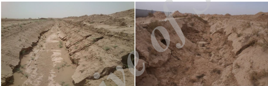
شکل 2- تخریب شیروانی زهکش روباز به دلیل فرسایش خاک
