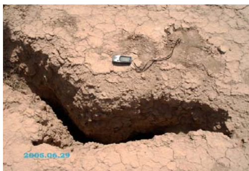
شکل ۲- الف ترک‌ها و شکستگی‌های زمین در رستاق
