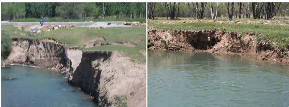
شکل ۷- فرسایش کناری در نتیجه سست بودن رسوب در بازه ۲
