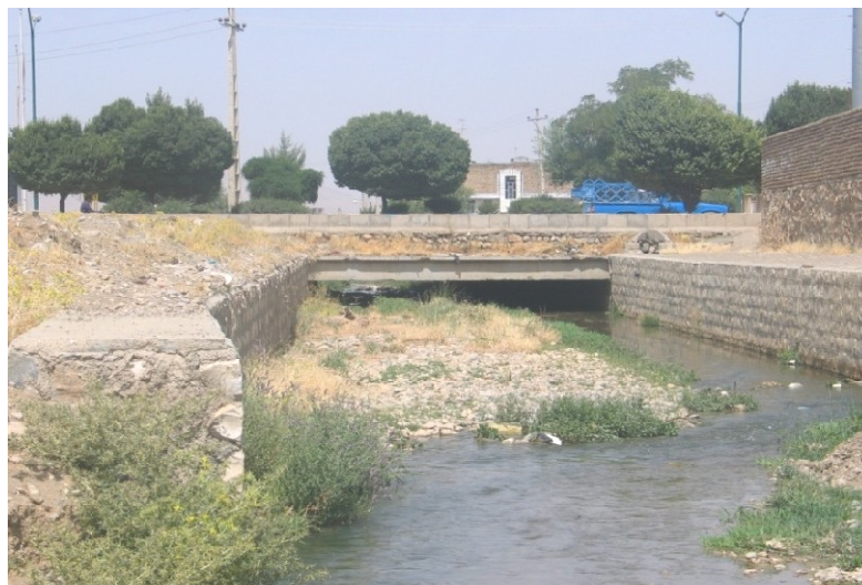
شکل ۱۲: ابعاد و ارتفاع نامناسب پل رودخانه سنقر چای
