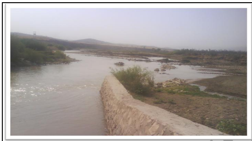
شکل ۹- ساخت سرریز بتنی و تغییر جهت مسیر رودخانه به علت ایستگاه پمپاژ آب در محل خمیدگی شماره پنج
