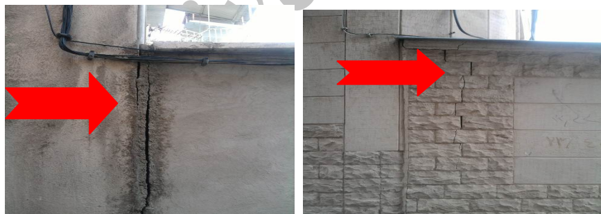
شکل (۲ و ۳) درز و شکاف ایجاد شده بر روی دیوار منازل نو ساز و قدیمی
