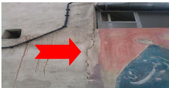
شکل (۴) درز و شکاف ایجاد شده در دیوار مسجد جامع در که.
