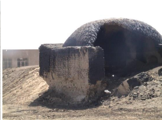
شکل ۱۴: تخریب دیوار شمالی اتاق در اثر ضربات ماسه‌ها
