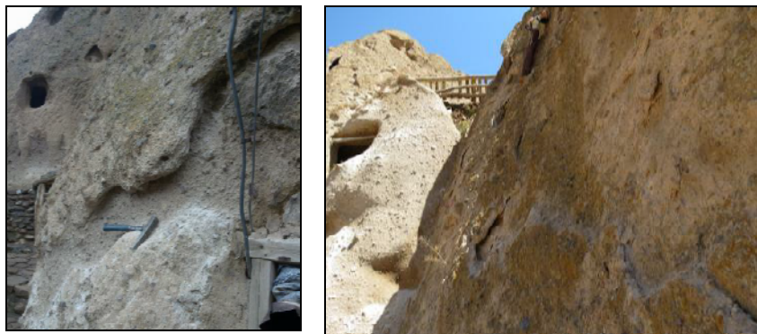
شکل (۸) تورق و ریزش سطح خانه‌ها در اثر هوازدگی فیزیکی
