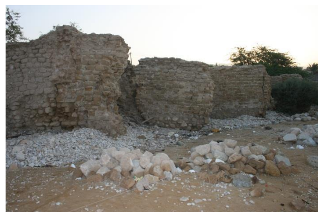
تصویر ۱۱- قطعات بزرگی از دیوارهای مجاور مسجد در حال جدا شدن از بدنه هستند (تصویر از نگارنده)
