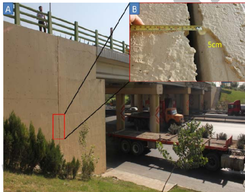
شکل ۹ آسیب پذیری پل آزادگان (تقاطع بزرگراه شهید رجایی و بزرگراه آزادگان) A: ایجاد شکستگی عمودی در گوشواره ابتدای پل به میزان ۵ سانتی متر B: نمای نزدیک از شکستگی عمودی در پل آزادگان
