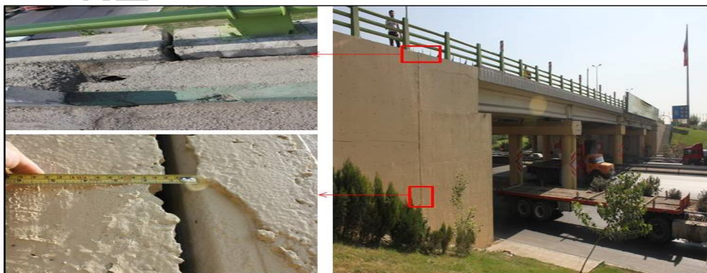
شکل شماره ۶: تصویر ایجاد درز و شکاف در پل بزرگراه آیت الله سعیدی ناشی از پدیده فرونشست (عکس: نگارنده)
