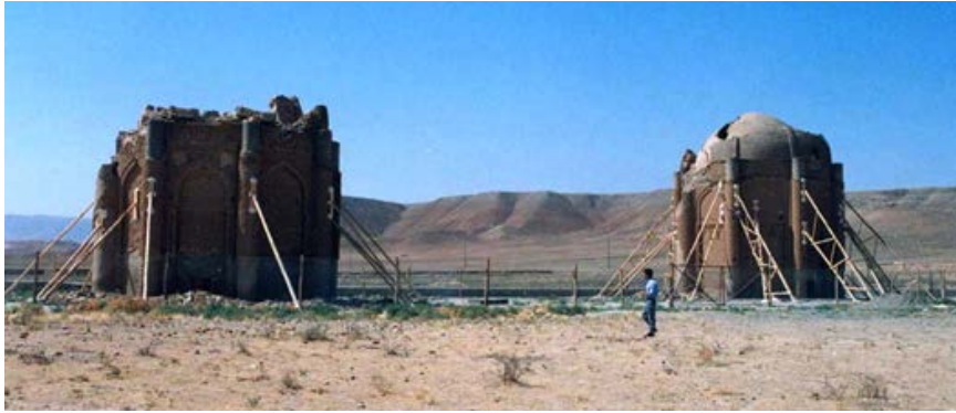
تصویر ۲. برج‌های خرقان پس از زلزله (سمت چپ: برج شرقی؛ و سمت راست: برج غربی)، (نگارنده، ۱۳۸۱). ◀
