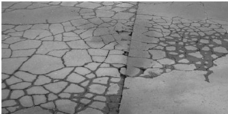
شکل(۱): ترک‌های کوچک بر روی مسیر بر اثر زلزله (منبع: نگارنده)
