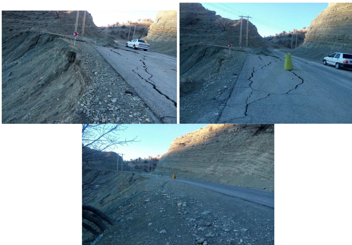
شکل ۵: نمونه‌هایی از لغزش زمین به علت احداث جاده
