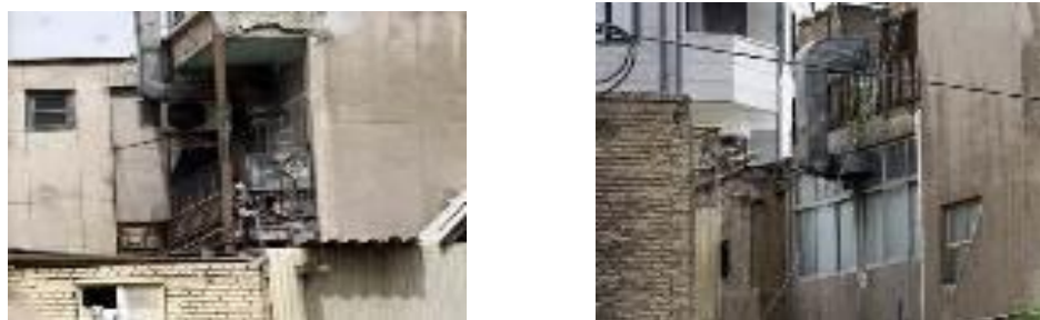
شکل ۱۵. عناصر الحاقی سست و ناپایدار در نمای ساختمان ها به تشدید آسیب پذیری محیط میانجامد ماخذ: نگارندگان
