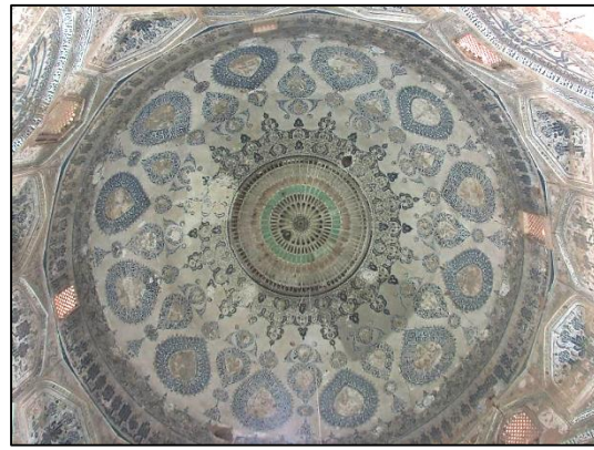
شکل ۲: آرایه‌های معماری سقف گنبد بقعه سیدرکن‌الدین Fig. 2: Architectural arrays of dome roof of Rokn al-Din mausoleum
