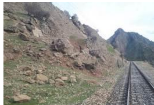
ترانشه ناپایدار کیلومتر ۴۲۶+۵۰۰
