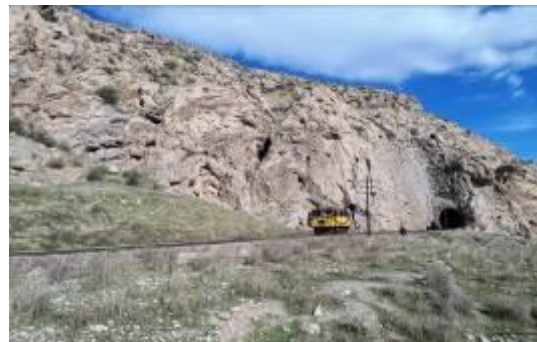
ترانشه ناپایدار کیلومتر ۴۷۶+۵۰
