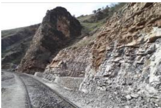
ترانشه ناپایدار کیلومتر ۵۱۸+۷۰۰
