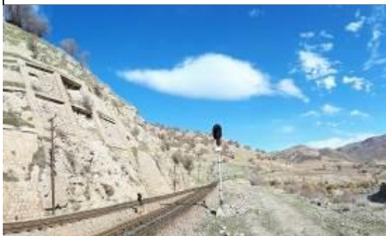
ترانشه ناپایدار کیلومتر ۴۷۷+۸۵۰
