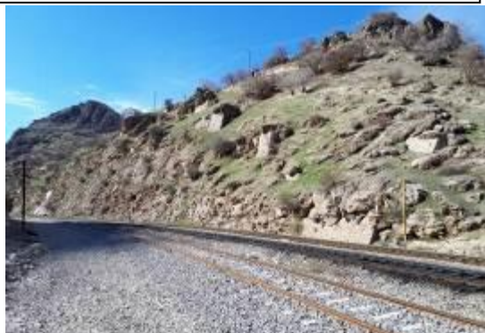
ترانشه ناپایدار کیلومتر ۴۷۹+۱۰۰
