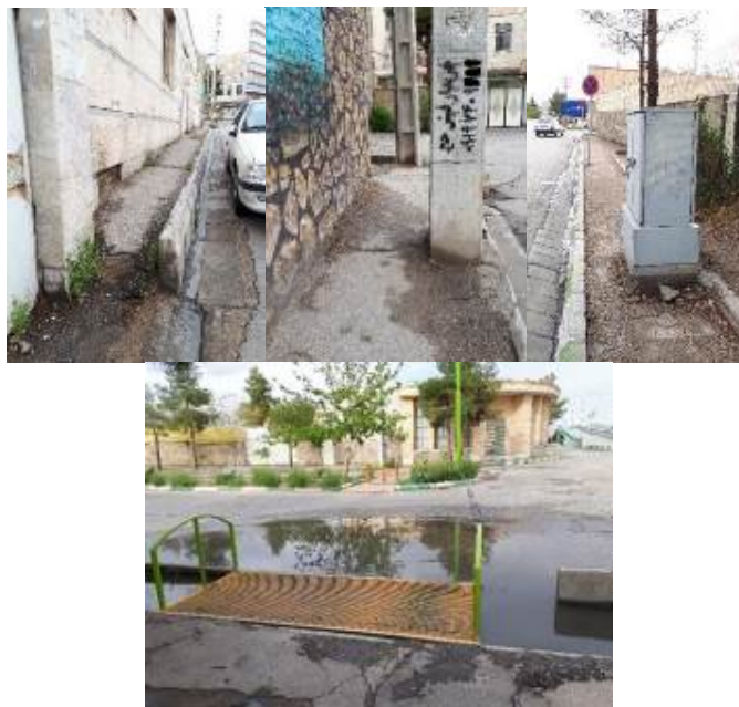
تصویر ۲: عرض کم پیاده رو- کف سازی نامناسب- اختلاف ارتفاع زیاد پیاده رو- آبگرفتگی معبر (منبع: نگارنده)
