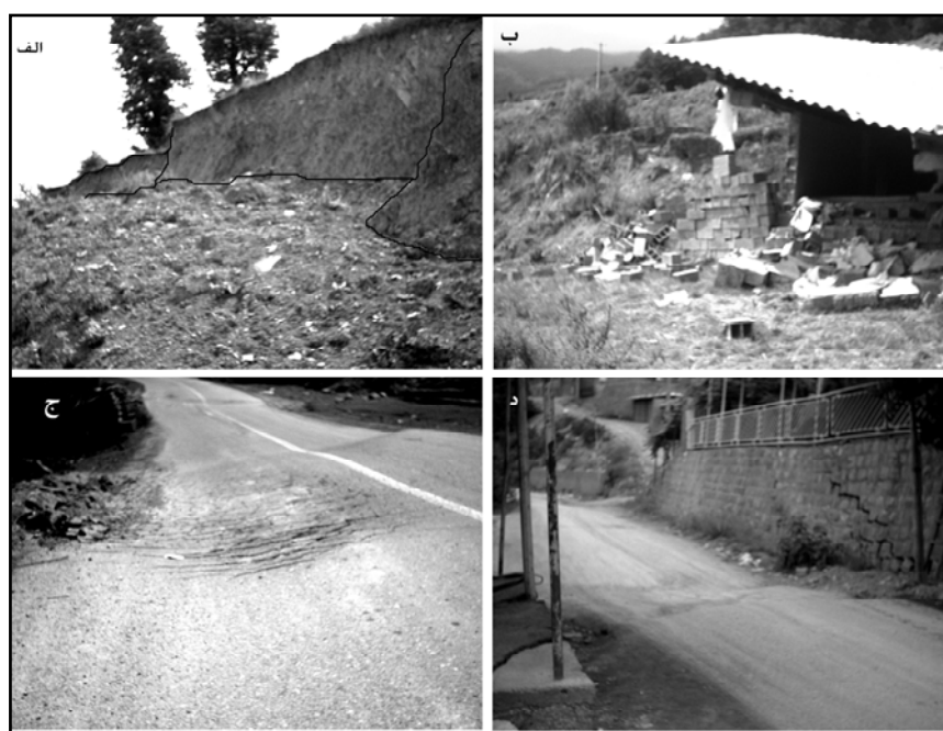
شکل ۱: نمای برخی حرکات زمین‌لغزه‌ای در منطقه چلاو.
