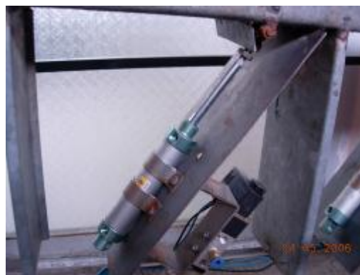
شکل ۴- کارانداز بادی نصب شده بر روی دریچه خروجی
