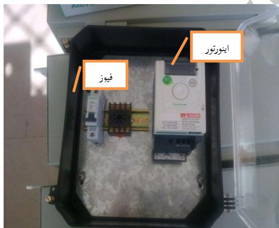
شکل ۱- اینورتور و فیوز سوار شده روی تابلو
