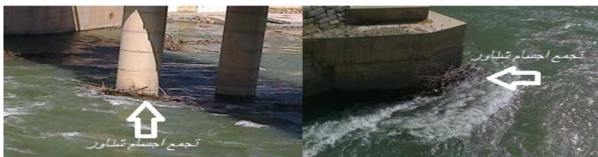
شکل ۱- تجمع اجسام شناور چوبی در جلو پایه پل.
