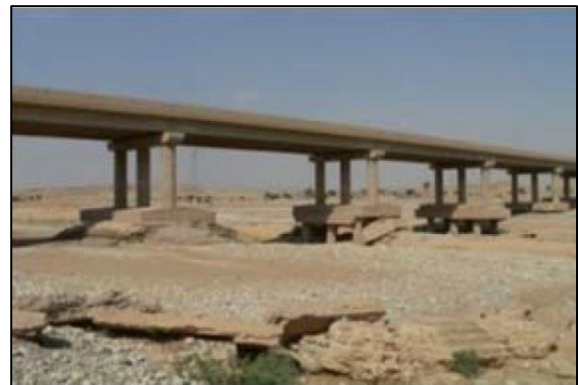
شکل ۲- تخریب ناشی از آبشستگی (پل گلال کهنک).
