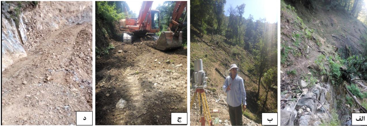
شکل ۲- تصاویری از مراحل اجرای پژوهش: الف) عرض پاک‌تراشی شده جاده؛ ب) برداشت مسیر جاده با ابزار لیزر اسکنر زمینی؛ ج) عملیات ساخت با دستگاه بیل مکانیکی؛ د) مقطع عرضی جاده بعد از اجرای عملیات خاکی.
