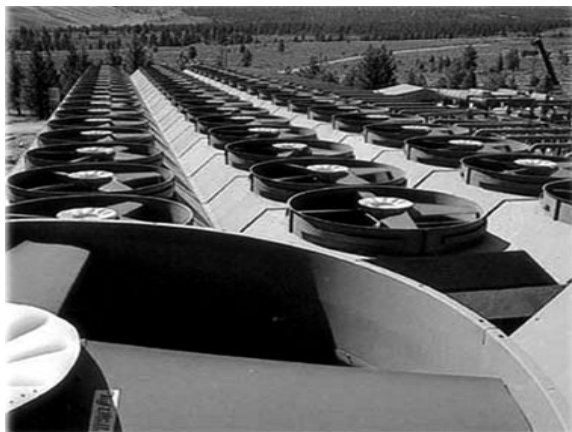
شکل ۱- نمایی از فن‌های موجود در یک کولر هوایی
