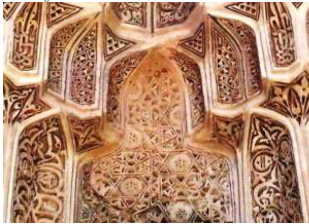
تصویر ۲۲- نمای نزدیک طاقنمای محرابی بزرگ قسمت مرکزی در ایوان اولجایتوی مجموعه بایزید(منبع: نگارنده).
