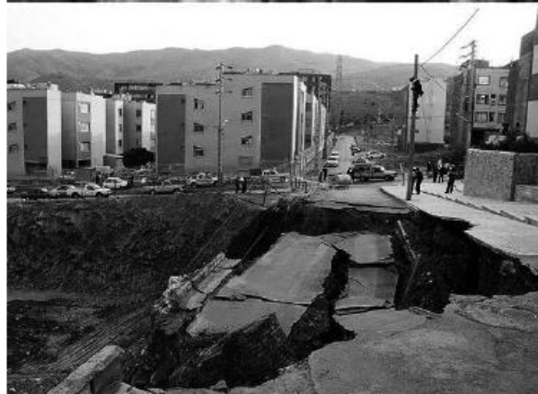
شکل ۱. بالا: نمونه ای از یک لغزش بزرگ انتقالی و تخریب یک مجتمع در حال ساخت در خیابان هاشمیه (سال ۱۳۸۵) پایین: ریزش حاصل از گودبرداری در سنگ های اولترابازیک خیابان هاشمیه (سال ۱۳۹۲)
