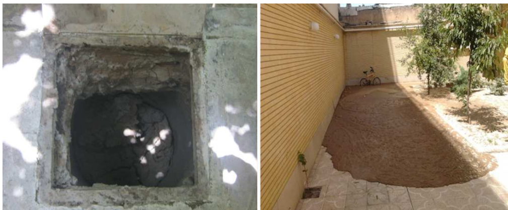
شکل ۱۳. نفوذ مخلوط فوم و خاک حفاری و پرشدن چاه جذبی (چپ) و راهیابی آن به حیاط یک ساختمان (راست)
