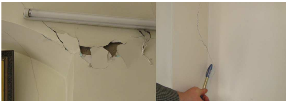
شکل ۱۷. تصویری از ترک‌های ایجاد شده در ساختمان‌های مسکونی محدوده مورد مطالعه
