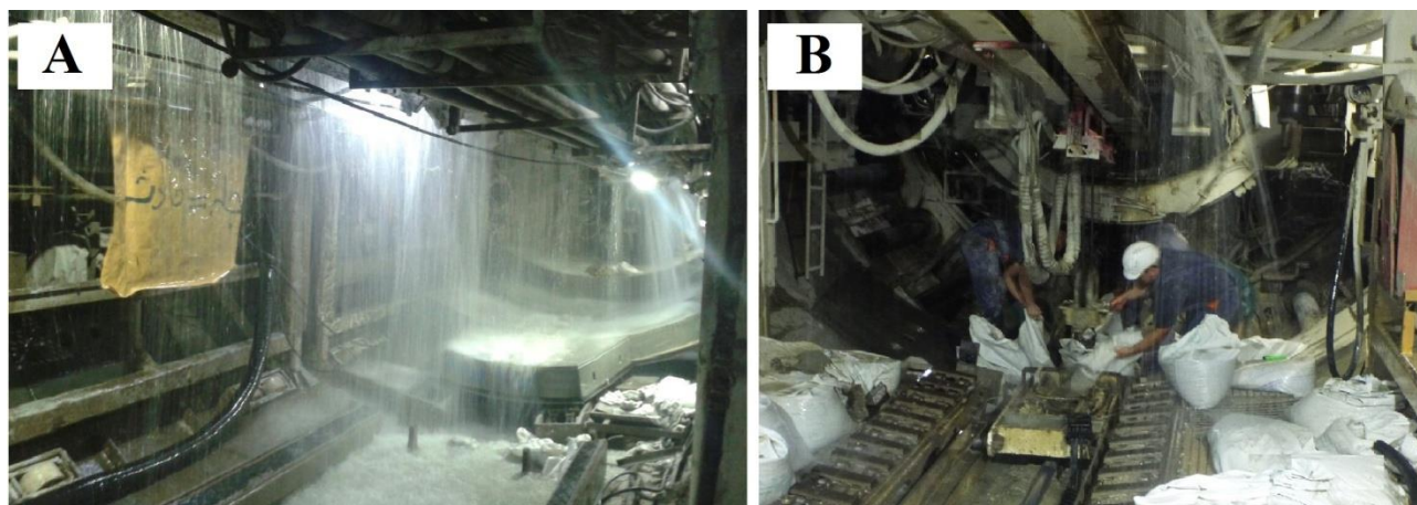
شکل ۱۲. A- ریزش مصالح سنگی حفاری به همراه جریان شدید آب از روی نوار نقاله. B- تمیزکاری و جمع‌آوری مصالح سنگی ریخته شده از روی نوار نقاله.
