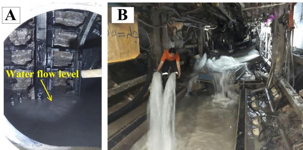
شکل ۱۱. A- دید از دریچه چمبر: متراژ ۵۶۲۰، نمایی از هجوم شدید آب از درز و شکاف توده سنگ آهکی تله زنگ و پُر شدن محفظه چمبر از آب و مصالح سنگی. B- نصب پمپ آبکش و هدایت جریان آب در شیب مثبت تونل.
