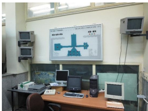
ج - اتاق کنترل
