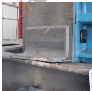
شکل (۱۶): تصاویری از شکستهای مشاهده شده
