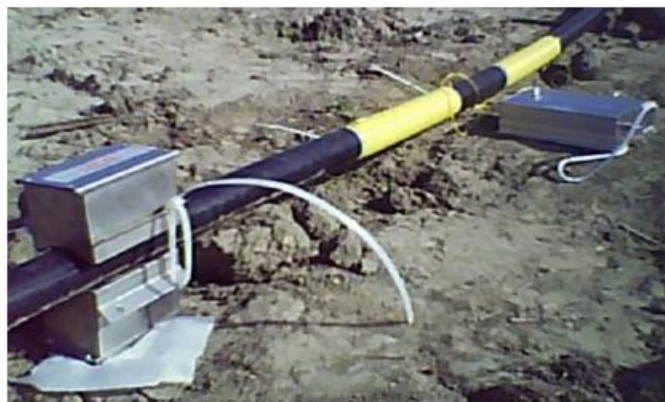
شکل ۳ دستگاه مغناطیس نصب شده بر روی لوله
