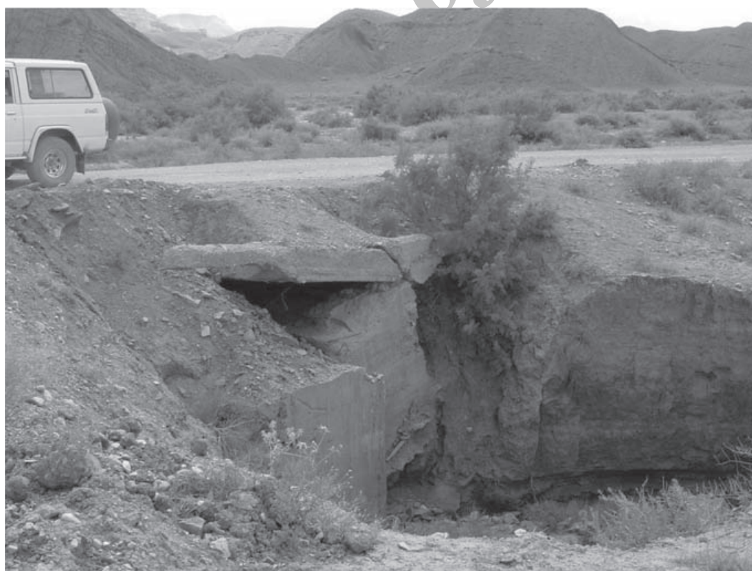
شکل ۵- نمایی از تخریب جاده توسط خندق در بیدگینه
