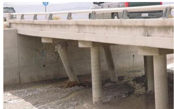
شکل ۲. نمونه‌هایی واقعی از تخریب پل‌ها بر اثر آبشستگی موضعی اطراف پایه‌های پل
