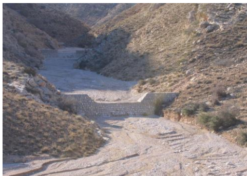
شکل ۵- نمای پایین دست یکی از بندهای سنگ و ملاتی که به دلیل کم بودن فاصله با بند بعدی حوضچه آرامش آن در رسوبات سد پایین دست دفن شده است.
