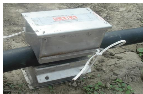
شکل (۲): دستگاه مغناطیس نصب شده بر روی لوله
