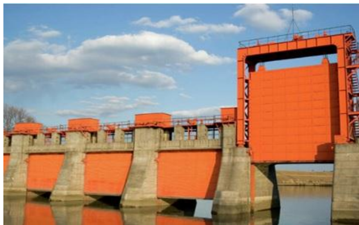
شکل ۱۲. نمایی از دروازه‌های آب در ژاپن
