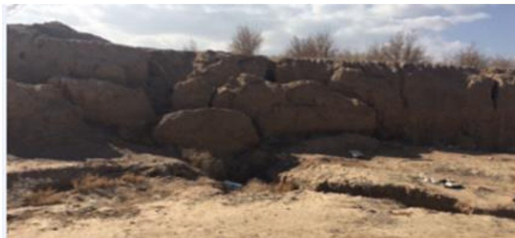
شکل (۳): نمونه‌ای از دیواره‌های فروچاله‌های دشتی در منطقه مورد مطالعه Figure (3): An example of the walls of the sinkhole plain in the study area
