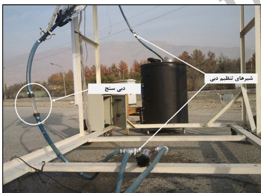
شکل ۴- شیرهای تنظیم دبی در سامانه گرمایش خورشیدی
