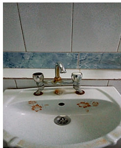
شکل ۳- تصاویری از خرابی شیرآلات و اتصالات سرویس بهداشتی خوابگاه
