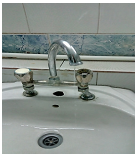
شکل ۲- تصاویری از خرابی شیرآلات و اتصالات سرویس بهداشتی خوابگاه
